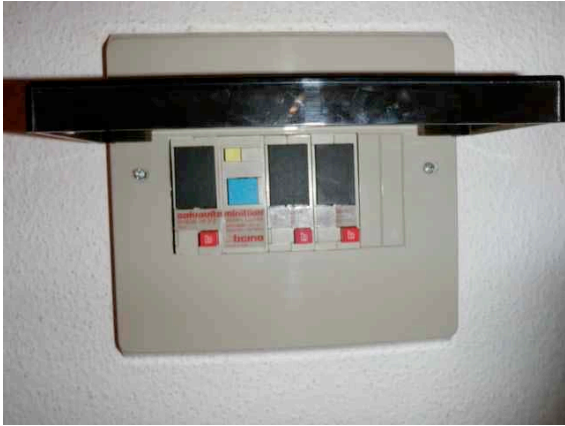
F. 25 Il centralino dell'impianto elettrico dell'u.i.u.
