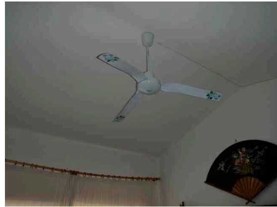
F. 26 Impianto di ventilazione nel soggiorno
