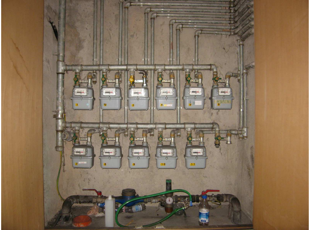
FOTO 9: atrio condominiale dell'edificio di Via Ghega 15 a Trieste, particolare contatori nell'atrio condominiale
