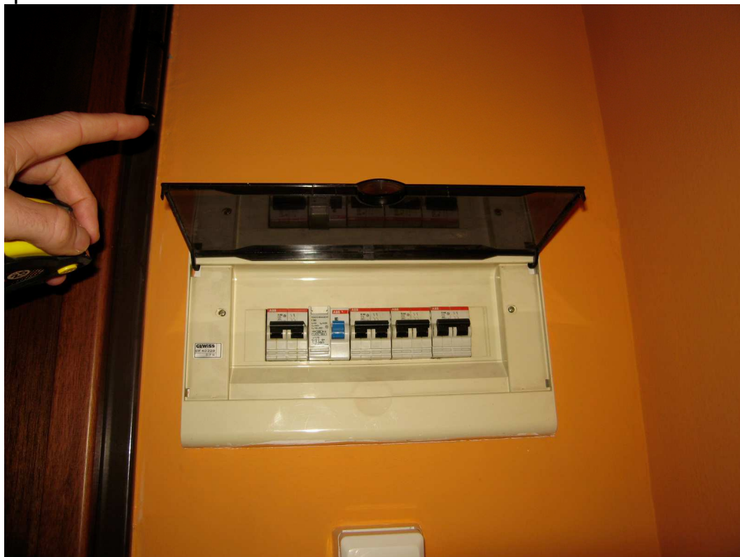
FOTO 17: Alloggio al terzo piano, subalterno "10", particolare quadro elettrico
