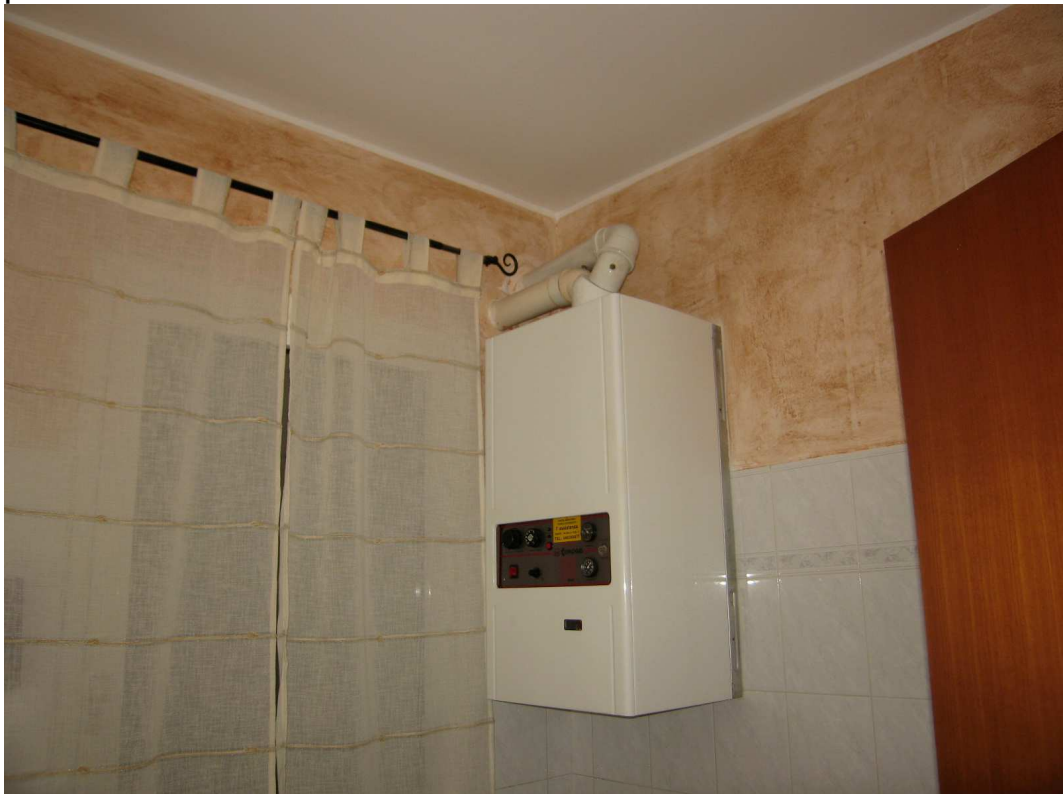
FOTO 42: Alloggio al terzo piano, subalterno "10", bagno w.c., particolare caldaia
