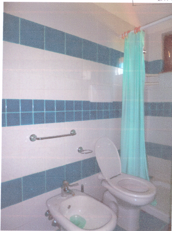
FOTO 22 - sub 3 - INTERNO PIANO PRIMO - BAGNO
