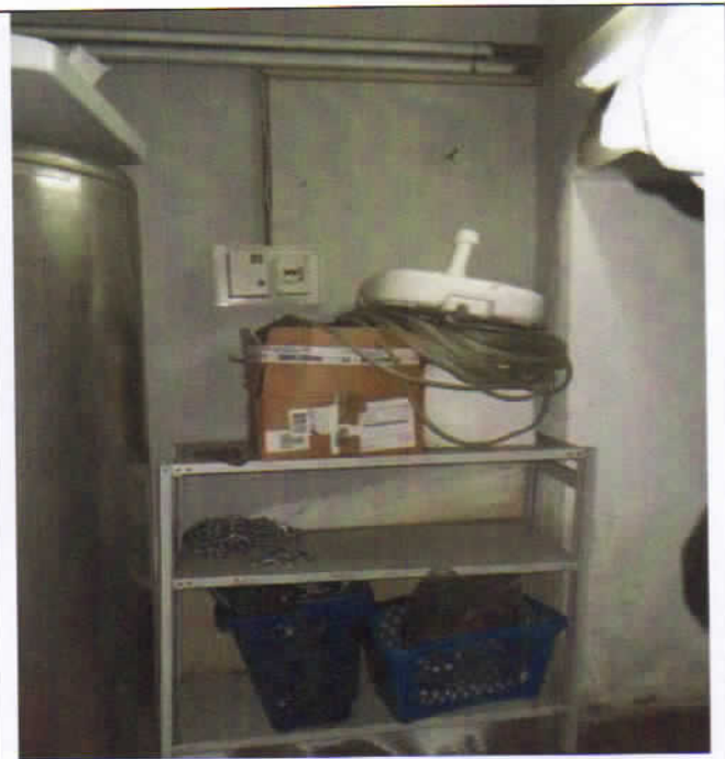
Foto 40 : Accesso diretto al vano tecnico
