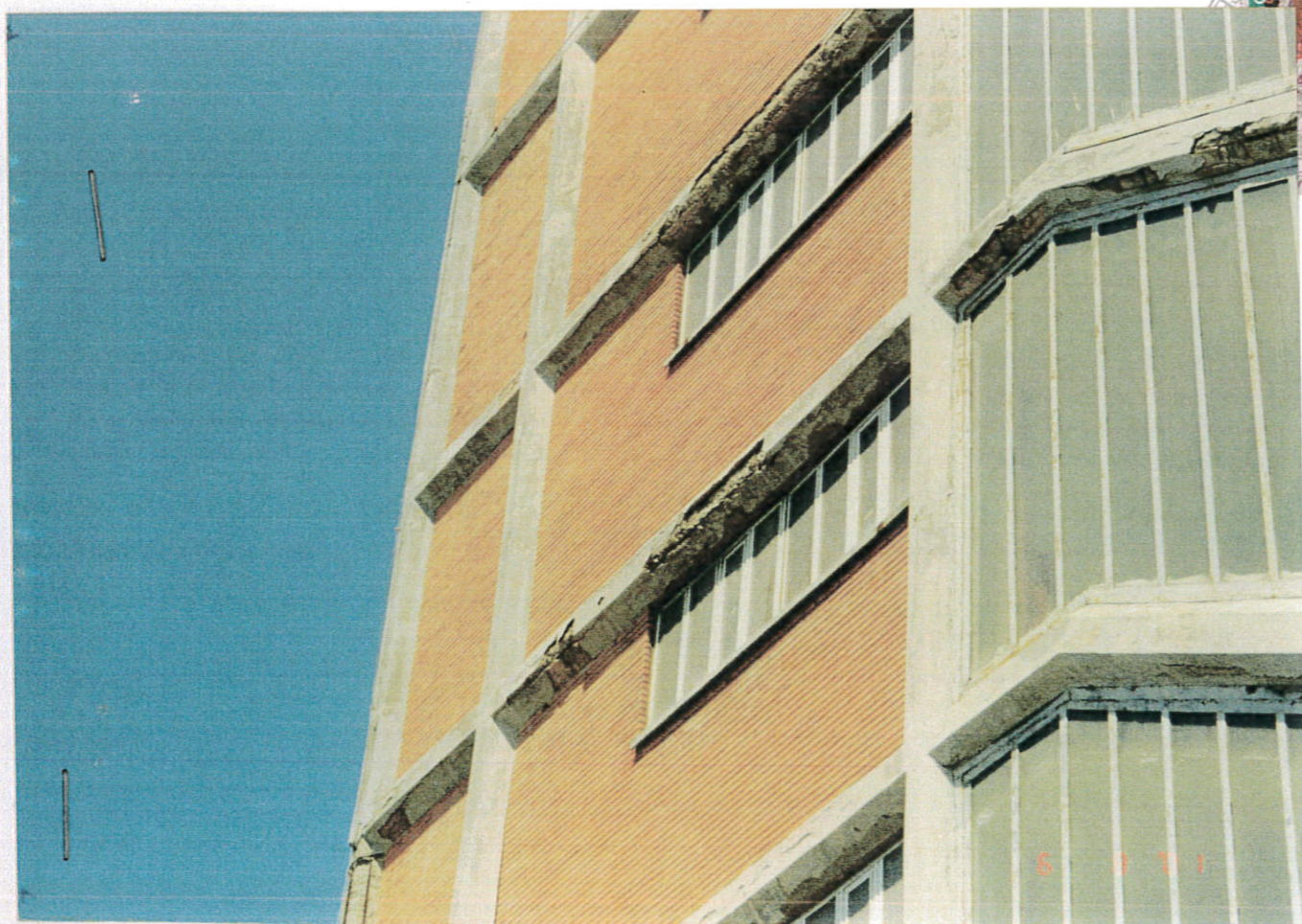
FOTO n° 6 : Ammaloramento delle strutture perimetrali a vista.
