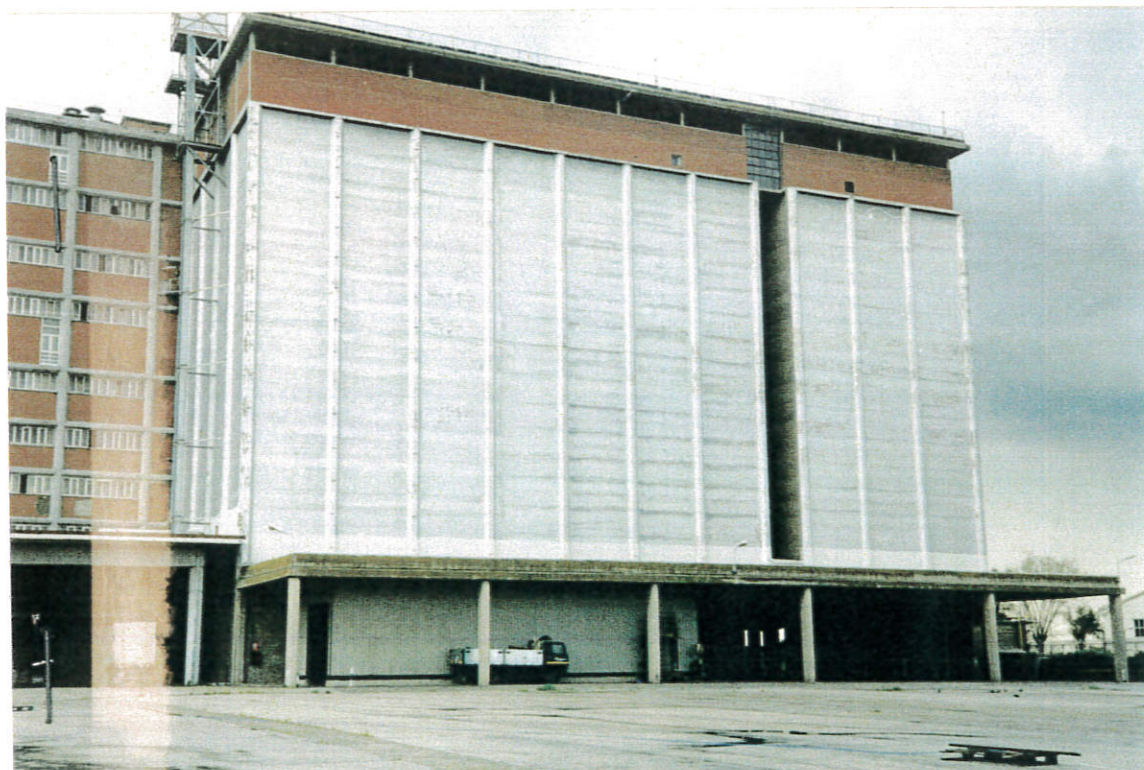
FOTO n° 2: Sono visibili i due silos e la pensilina antistante.
