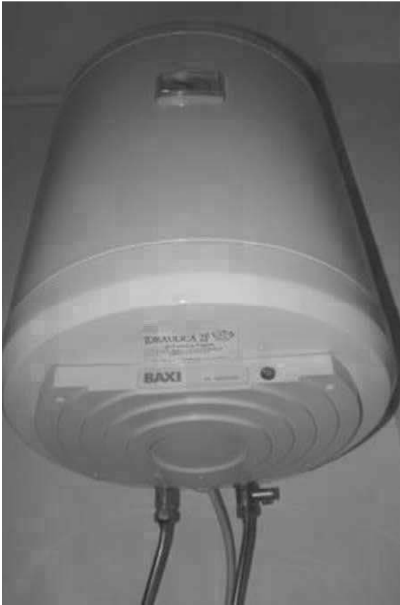
15. Dettaglio del boiler.
