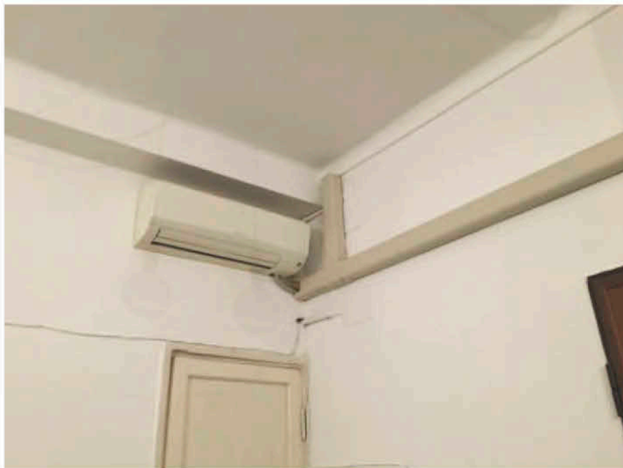
split impianto condizionamento
