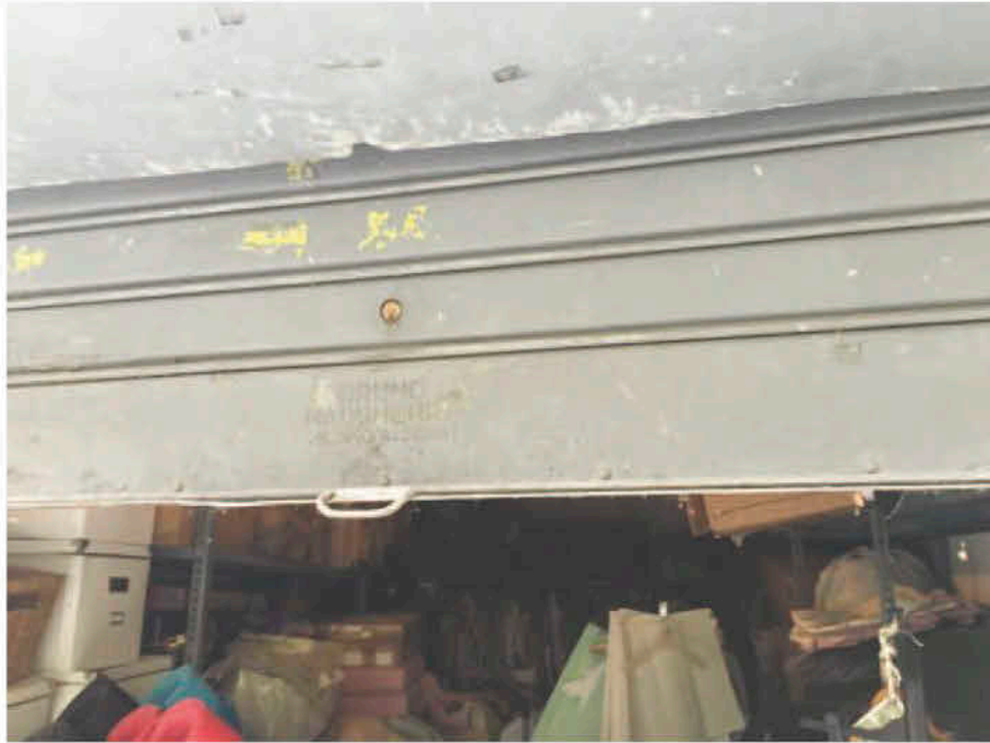
dettaglio serranda metallica
