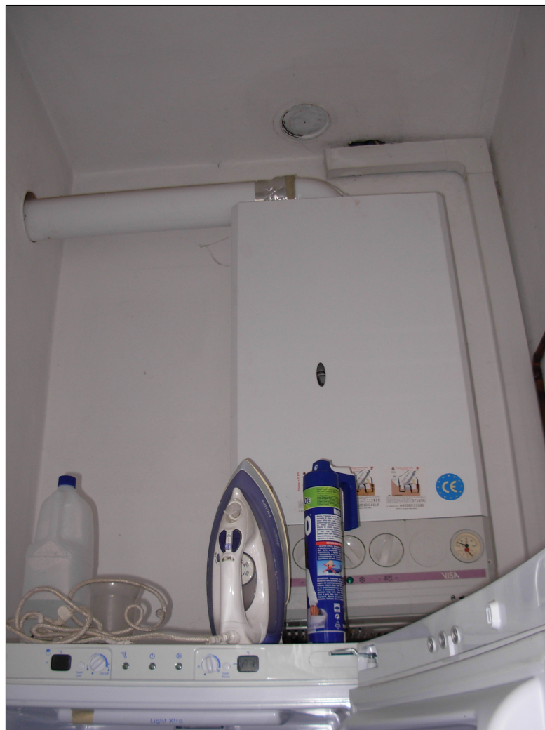
vista interna PT caldaia - ripostiglio
