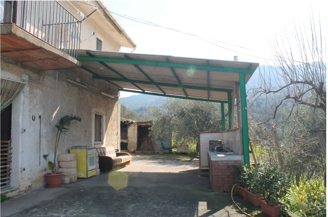
Prospetto della casa con struttura precaria antistante abusiva
