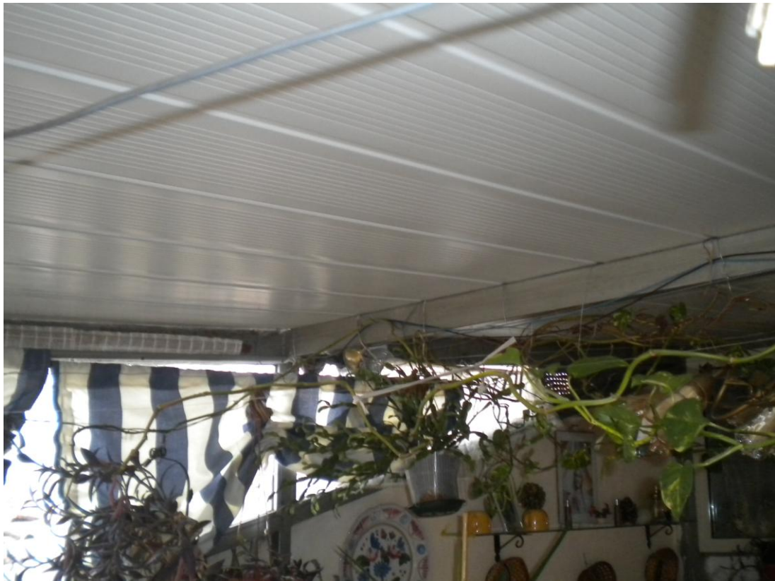
Foto n. 37 ( copertura veranda al piano secondo non accatastata)
