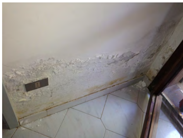
FOTO N.16: CUCINA PIANO TERRA (umidità)
