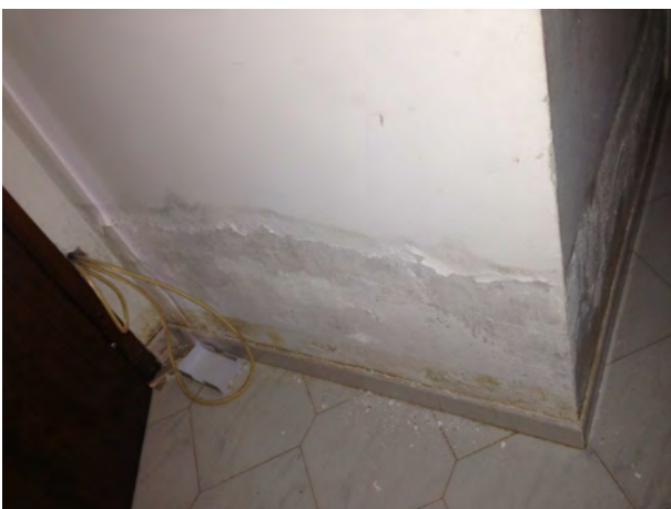
FOTO N.11: SOGGIORNO PIANO TERRA (umidità)
