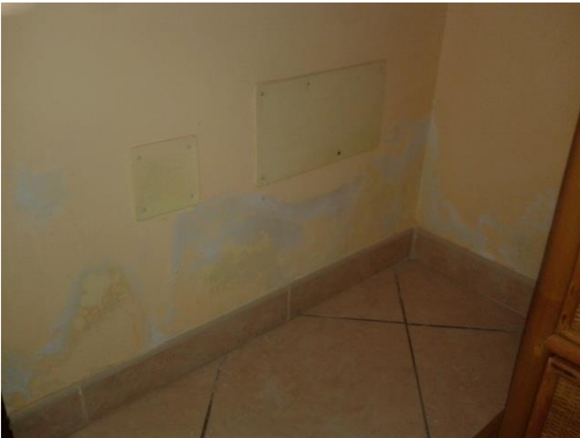
Figura 12 - Parti di intonaco ammalorato dovuto ad umidità di risalita presente nei vani a piano terra
