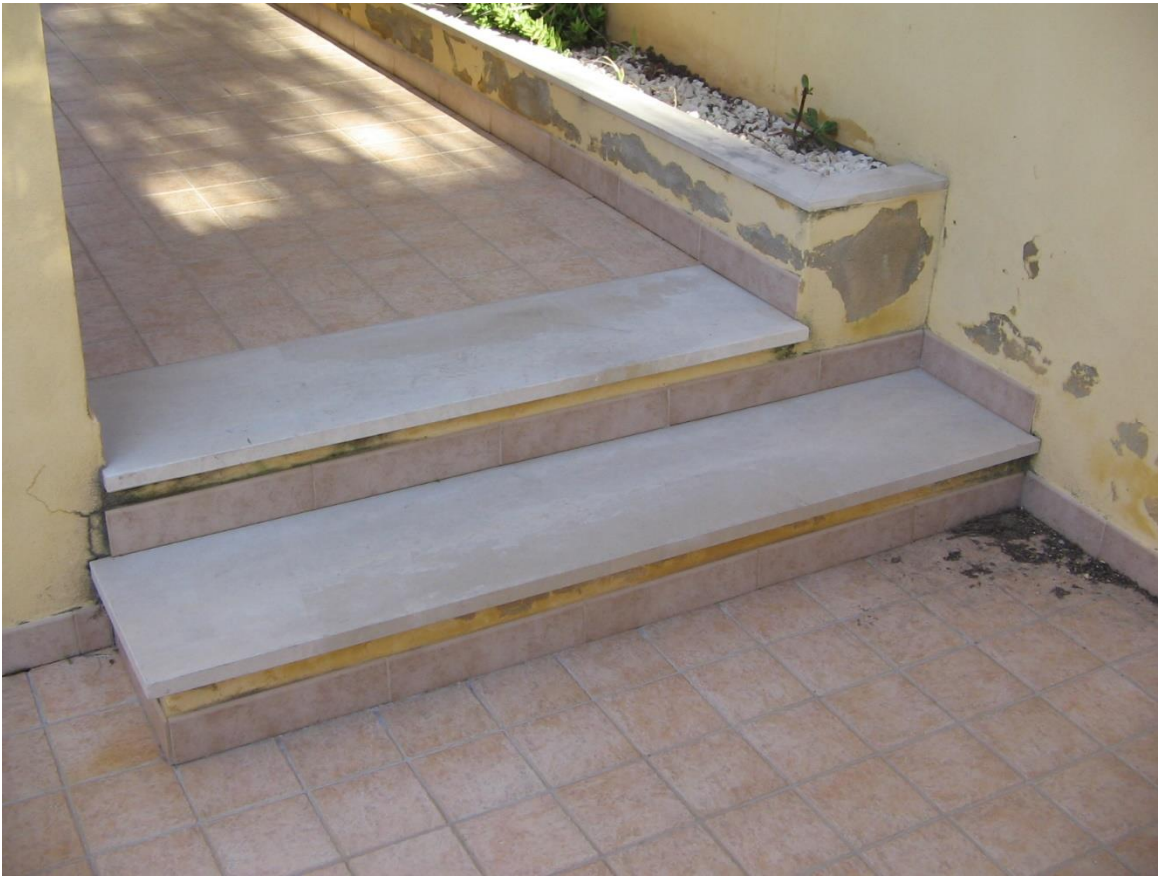
Figura 11 - Gradini di accesso e parti d'intonaco ammalorato a causa di umidità di risalita
