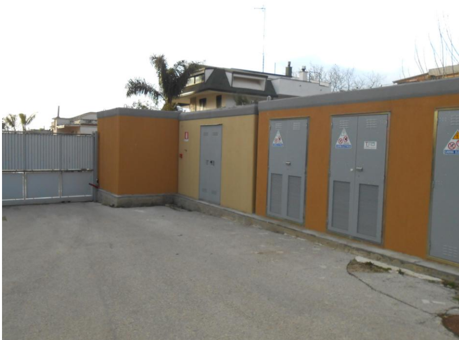
vista delle cabine di trasformazione ENEL
