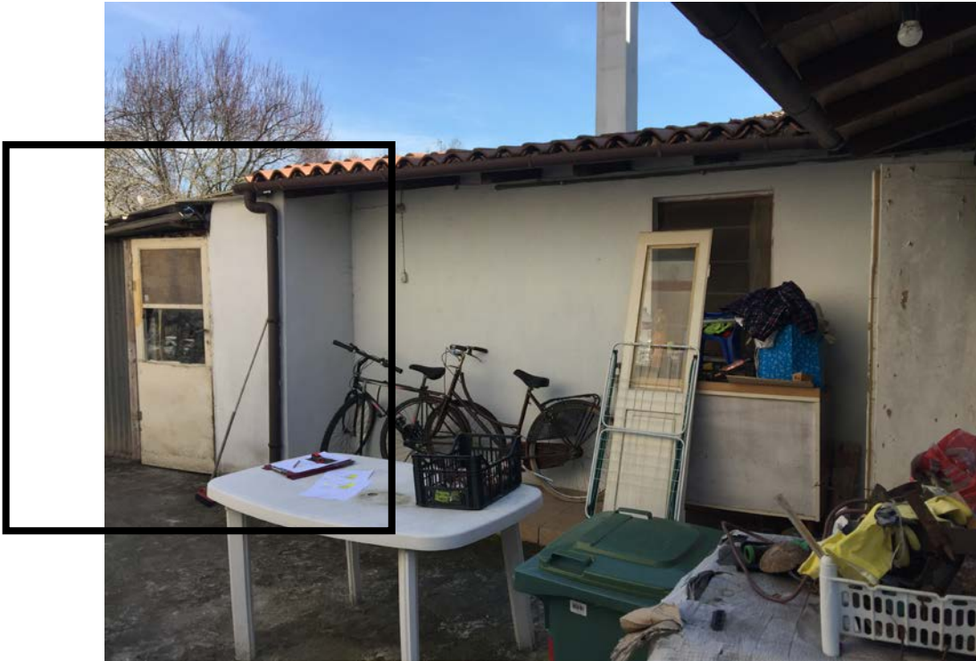
Modesto ampliamento e porticato in eternit: difformità
