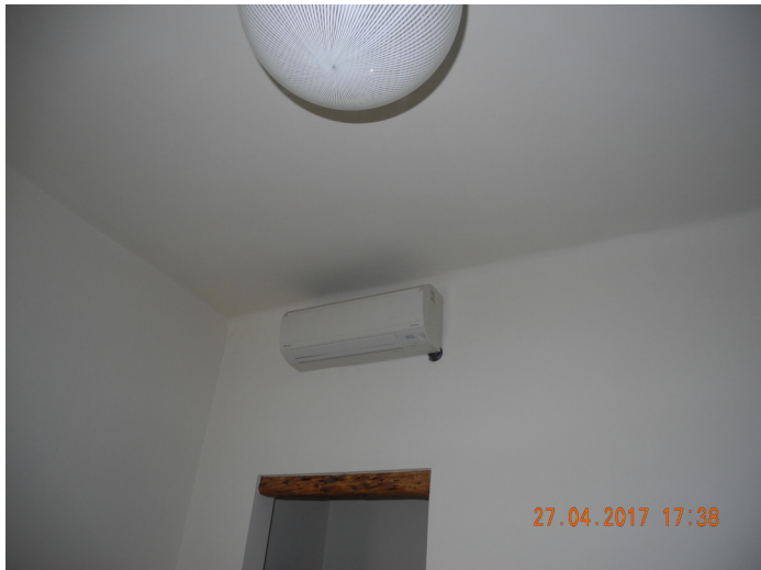
FOTO 21 – climatizzatore in camera matrimoniale
