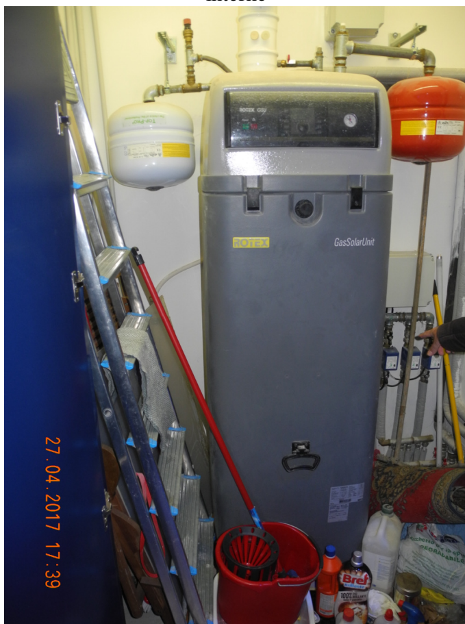
FOTO 9 – caldaia, in comune tra le 3 unità abitative interne
