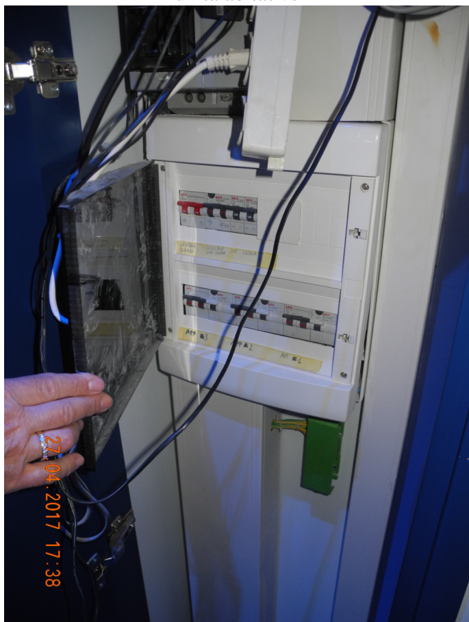
FOTO 7 – quadro elettrico di ripartizione linee tra le 3 unità abitative
