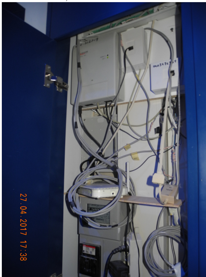
FOTO 8 – quadro di ripartizione linee telefoniche, modem, ecc. tra le 3 unità abitative
