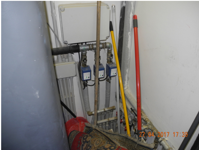
FOTO 10 – valvole di ripartizione dei flussi di riscaldamento tra le 3 unità abitative interne
