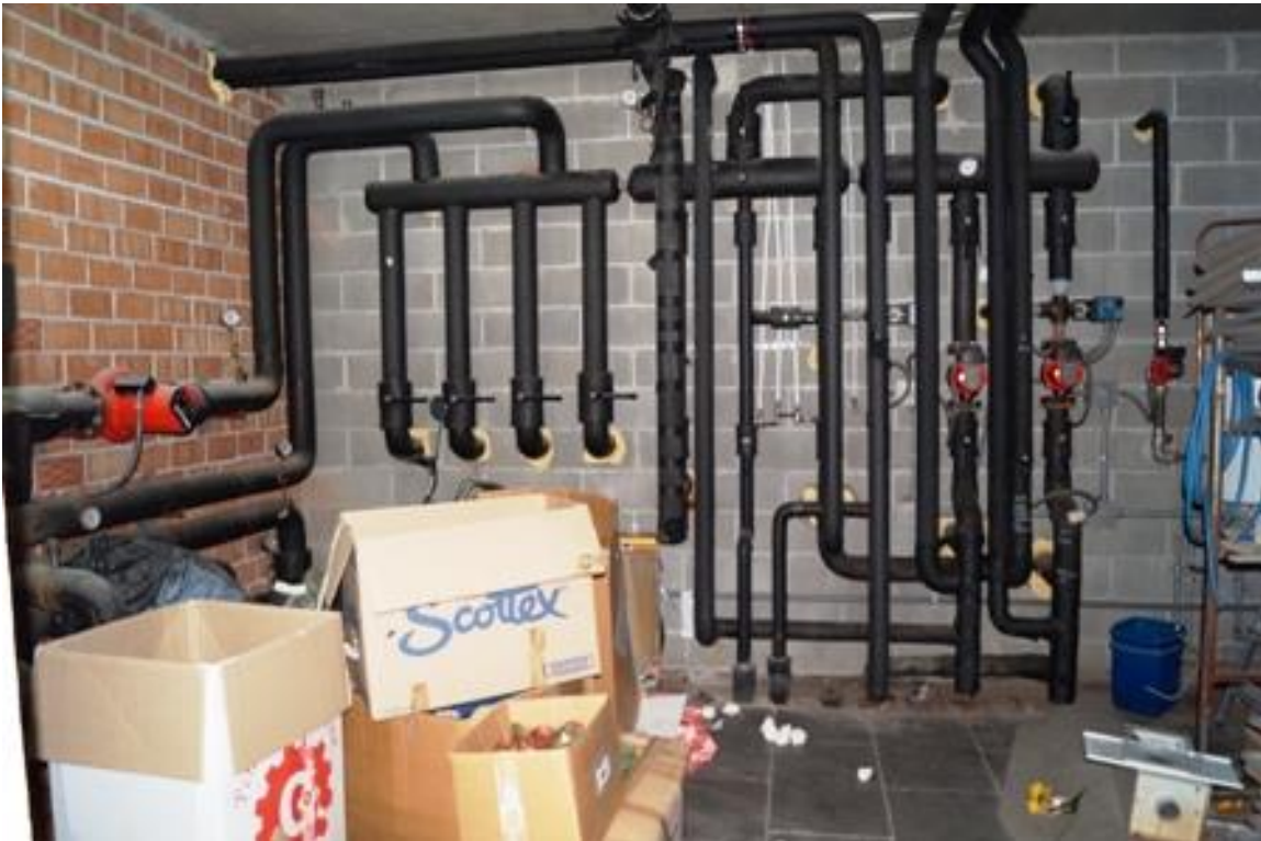
FOTO 11 CENTRALE TERMICA P.T. -Fabbricato 1
