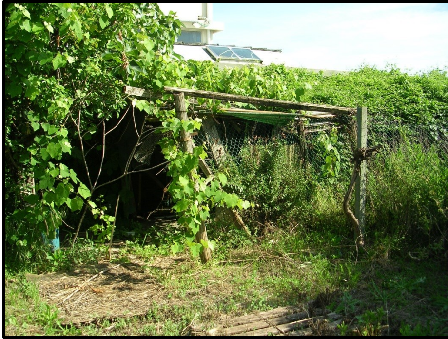
(particolare struttura precaria in legno che insiste sull'area a verde delimitata da rete metallica)
