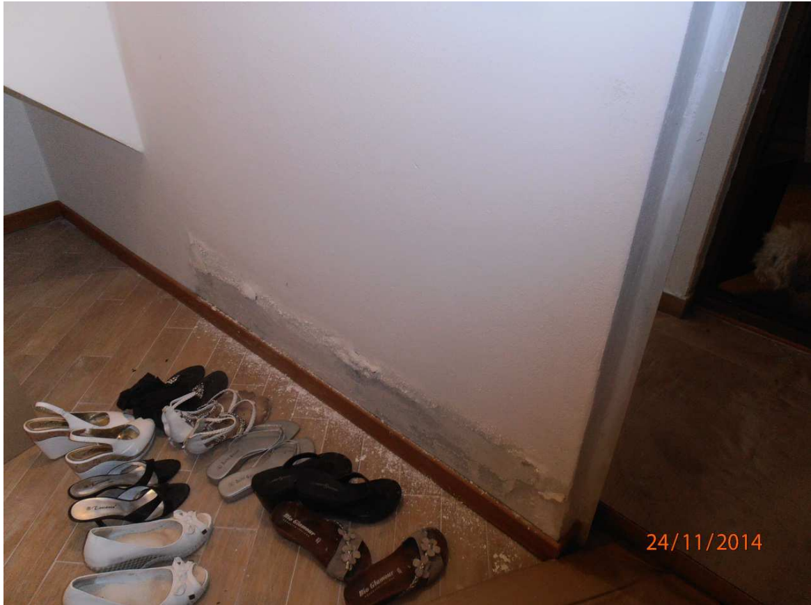
FOTO n. 37-P.T. 5160 - p.c.n. 409/8 sub 13 – Umidità di risalita al piano interrato
