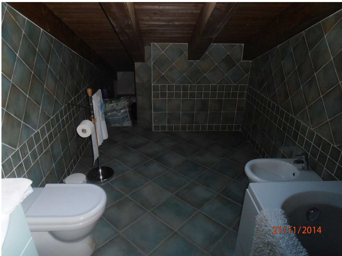
FOTO n. 26 – P.T. 5162 p.c.n. 409/8 sub 4 - Bagno al piano sottotetto
