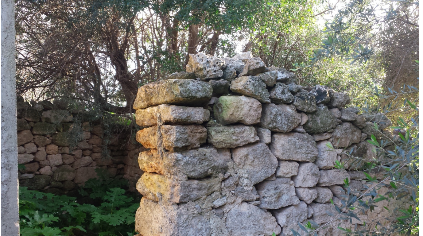
Foto n.9 - Magazzino (vano privo di copertura)
