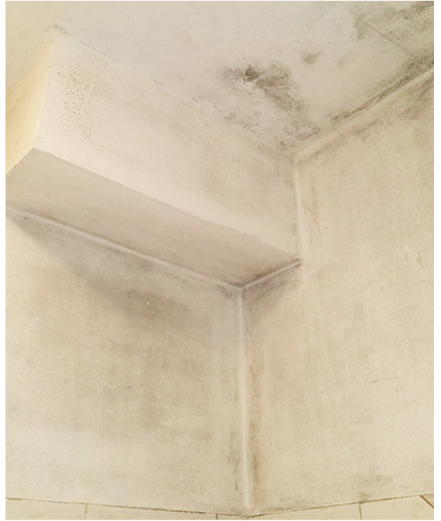
FO-40 Umido soffitto bagno
