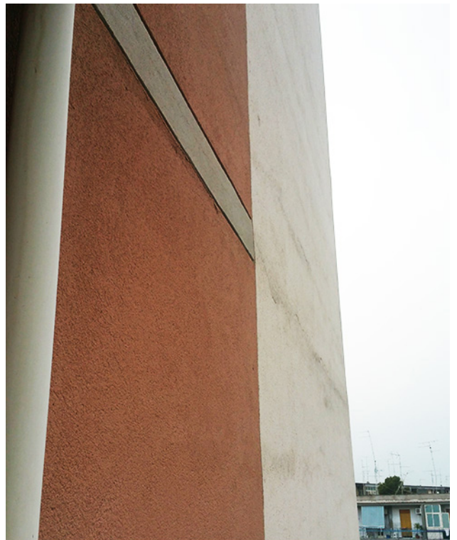
FO-42 Rigonfiamenti e fessurazioni in facciata
