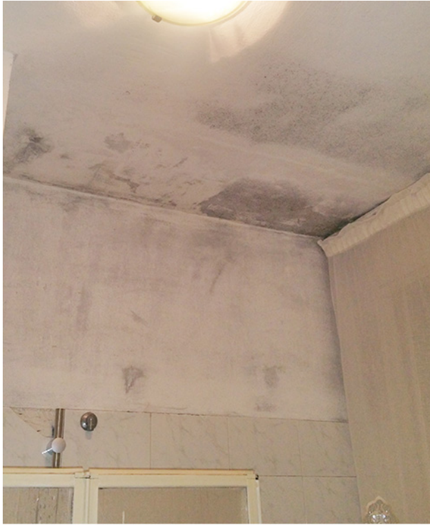
FO-39 Umido soffitto bagno
