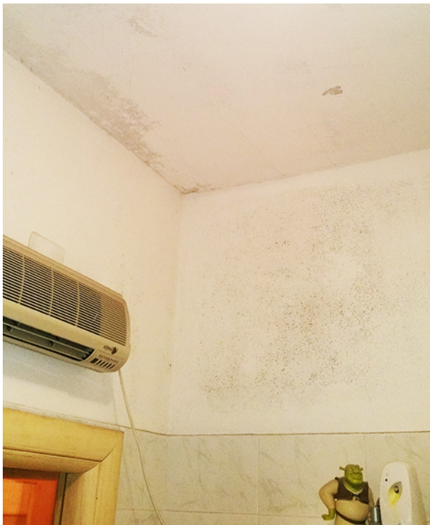
FO-41 Umido soffitto bagno
