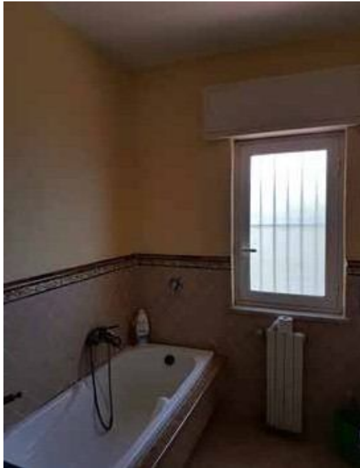
Foto 29. Pianoprimo, servizio igienico.
