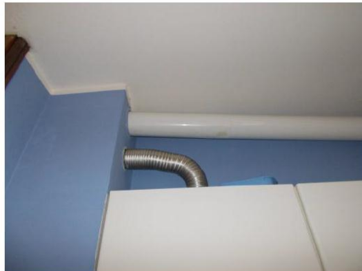
54. Dettaglio degli scarichi della cappa cucina e della caldaia interna
