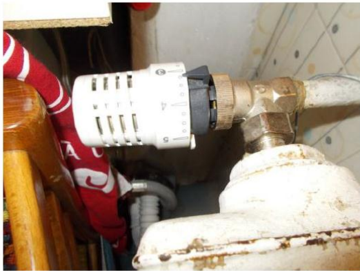
53. Particolare valvola di termoregolazione
