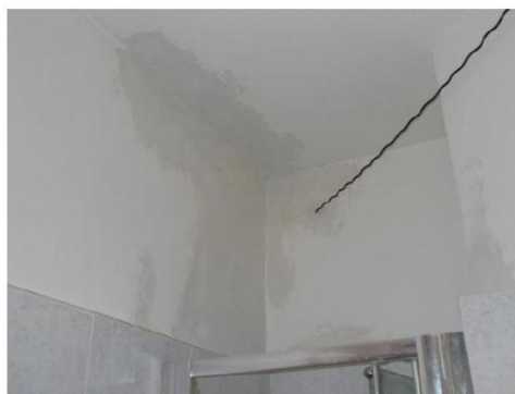
34. Macchia di infiltrazione nel bagno
