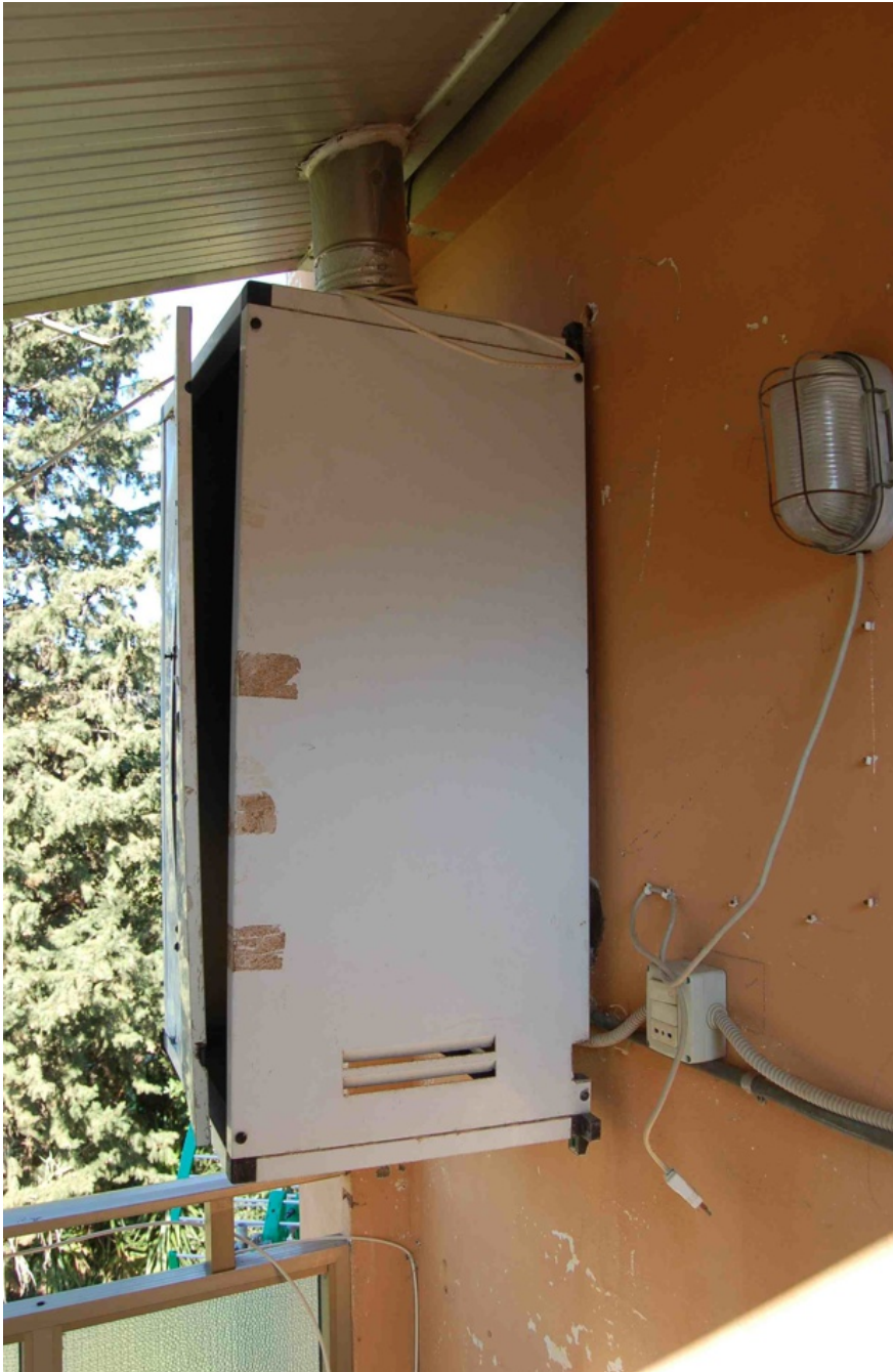
Immagine della caldaia a metano
