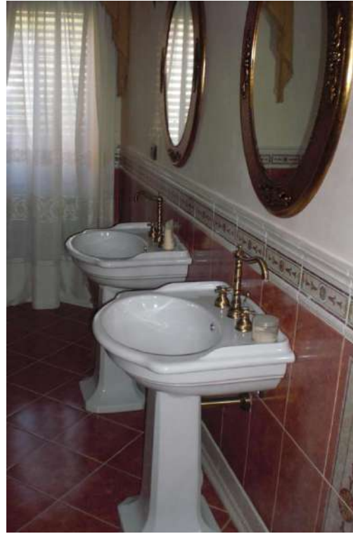
Foto 31 Vista del WC 2
