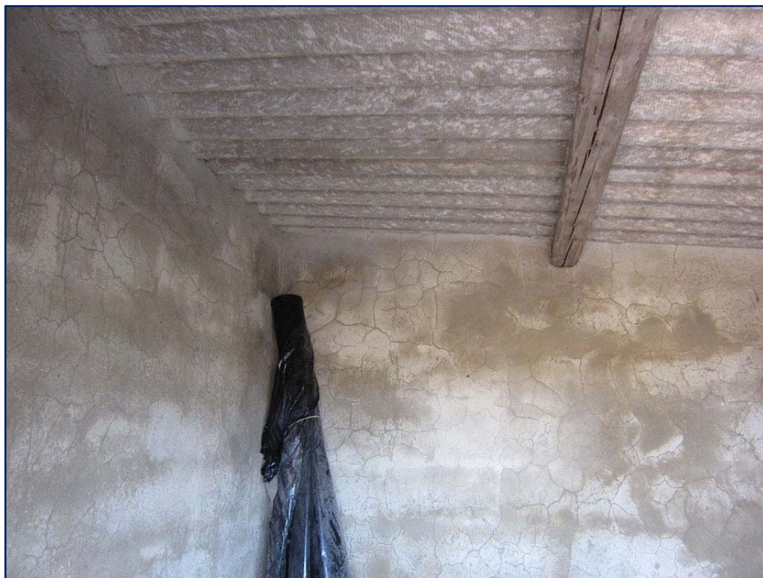
Foto-10 (Casotto al servizio del pozzo)
