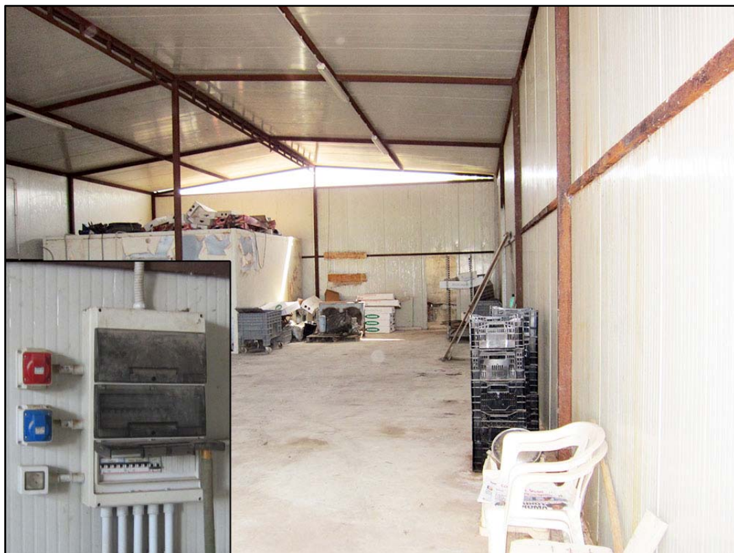
Foto-4 (Corpo A, nel particolare a sinistra, il quadro elettrico)
