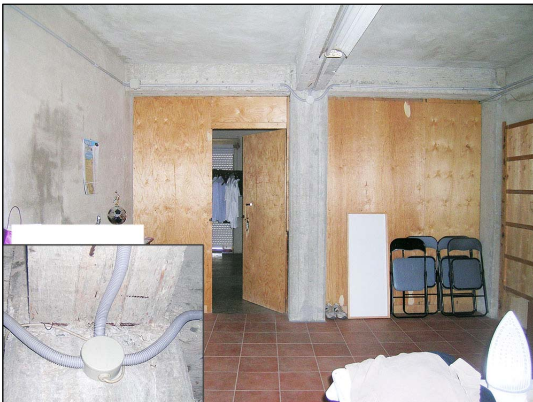
Foto-4 (Ambiente separato da pareti in compensato, nel riquadro particolare dell'impianto elettrico)
