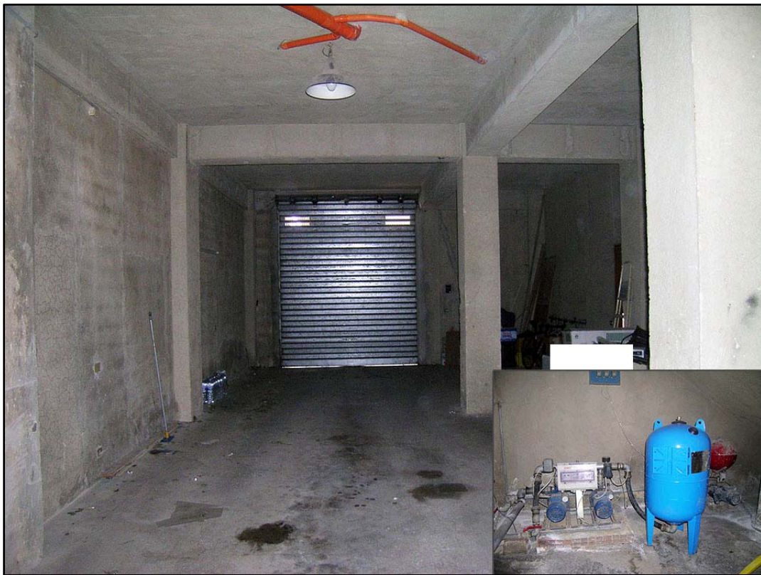
Foto-6 (Garage, nel riquadro a destra il vano tecnico con l'autoclave)
