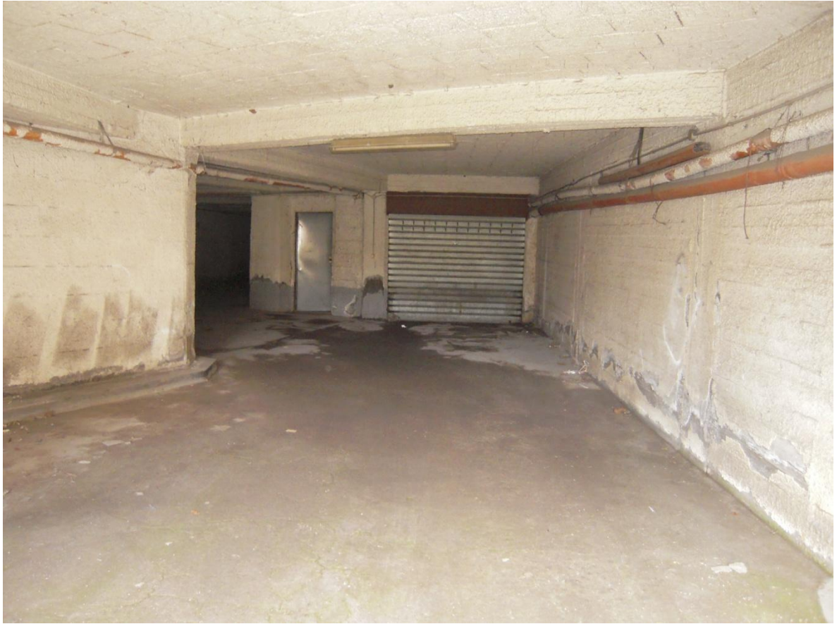
SARACINESCA D'INGRESSO GARAGE
