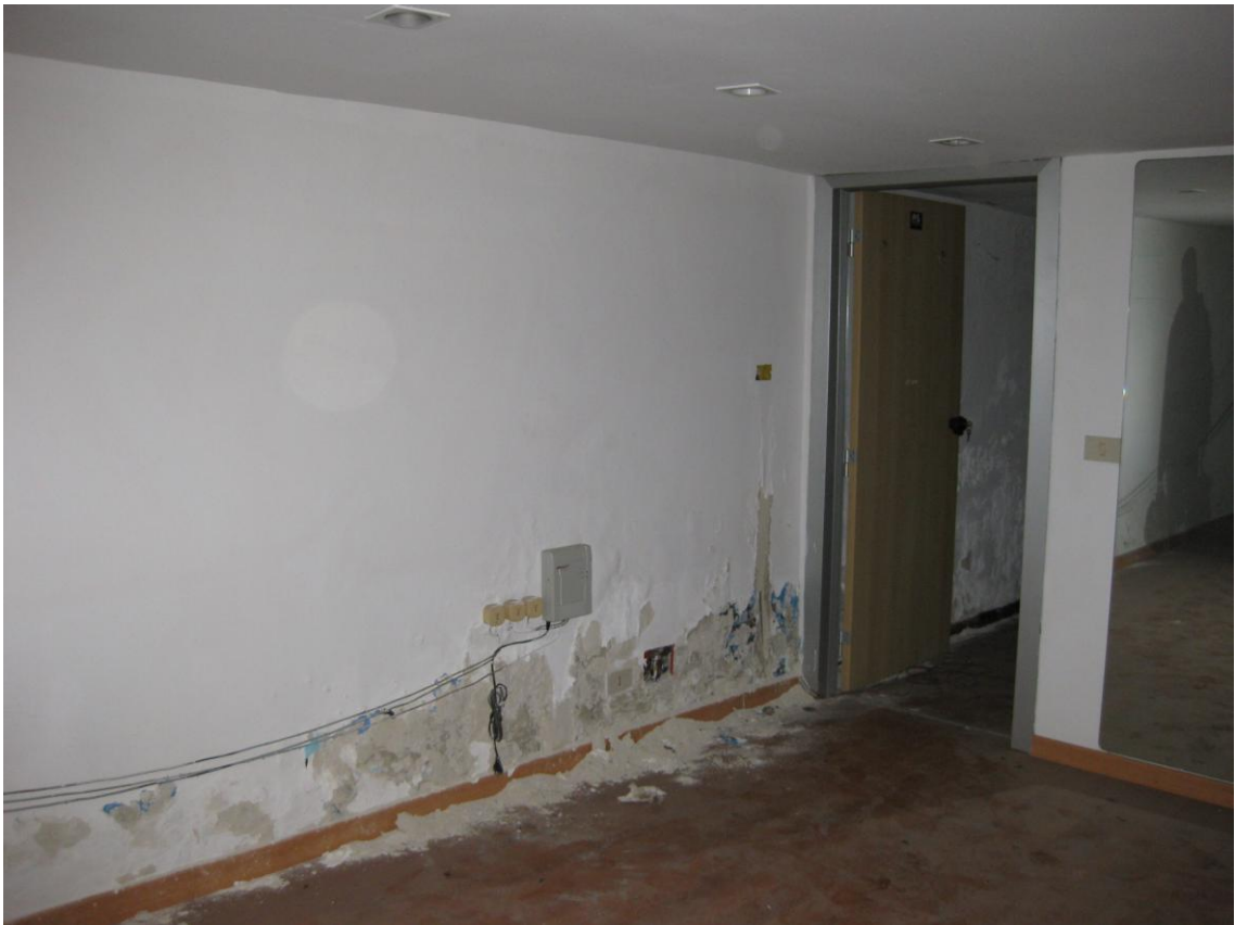
Foto 11: La porta che dal secondo ambiente, conduce al w.c.; particolare degli ammaloramenti lungo la porzione bassa del muro
