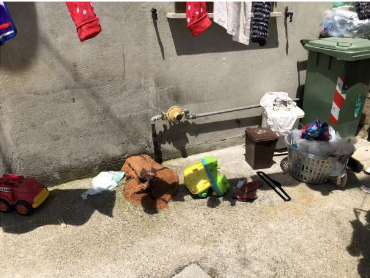
Foto 72 e 73: pozzetti per scarico in fognatura e allacci gas
