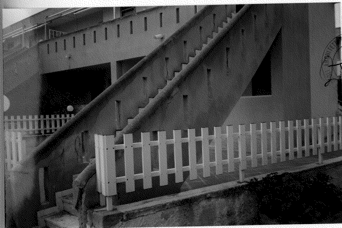
(foto n. 73) Le pessime condizioni in cui versa la scala di accesso
