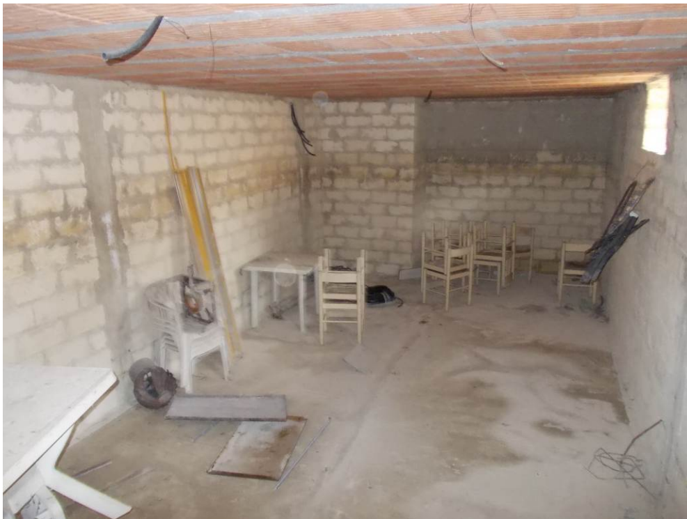
Foto 12 (piano seminterrato abusivo)
