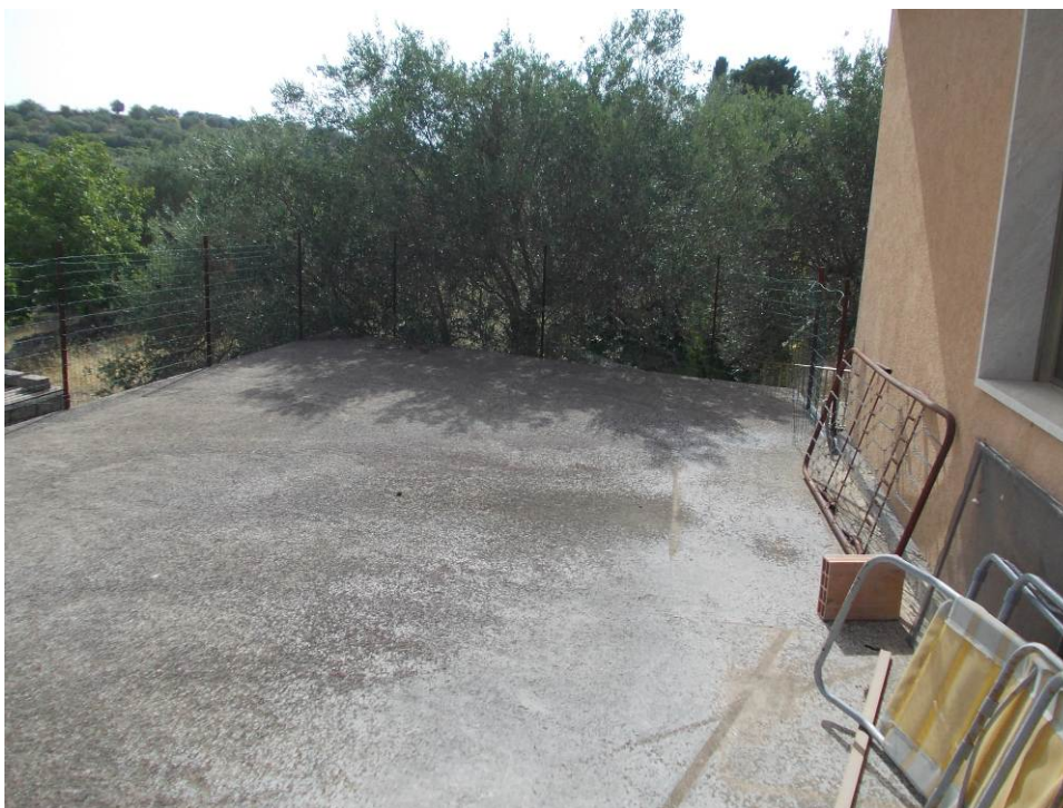
Foto 18 (terrazza – copertura della tettoia abusiva)
