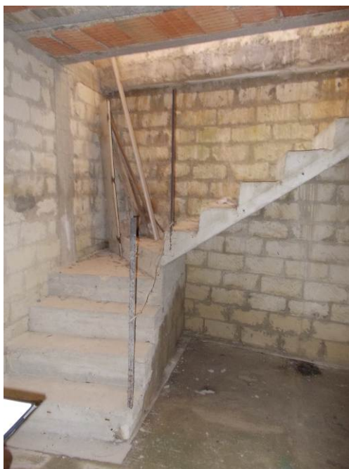
Foto 13 (scala di accesso al piano seminterrato abusivo)
