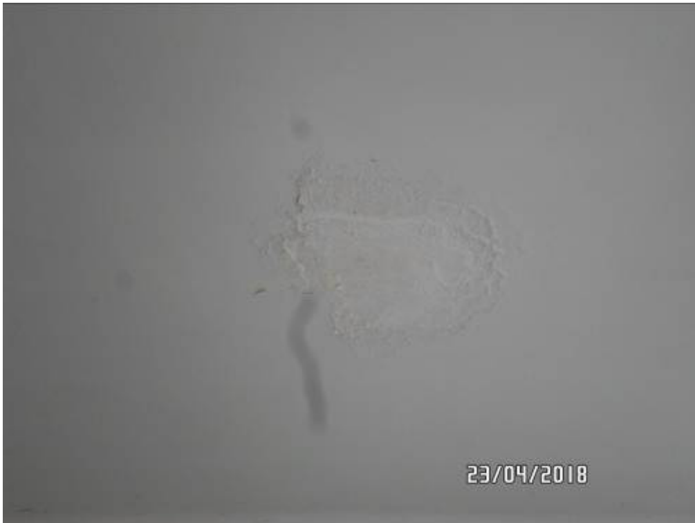
FOTO N. 7 Dettaglio fotografico dei danneggiamenti causati dalle infiltrazioni sul soffitto del locale adibito a soggiorno.
