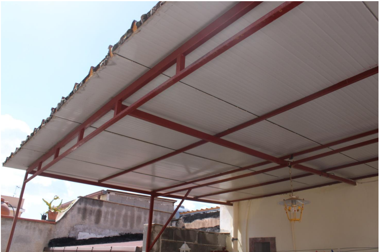
Porticato in ferro abusivo sul lastrico solare
