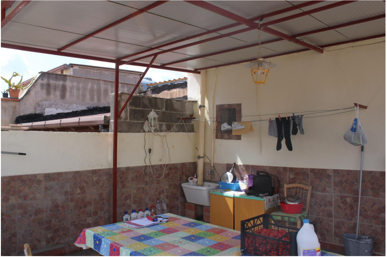
Porticato in ferro abusivo sul lastrico solare
