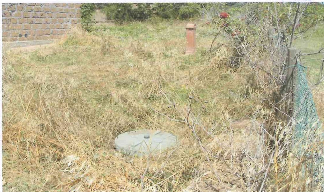
Particolare serbatoio gas GPL per l'uso domestico
