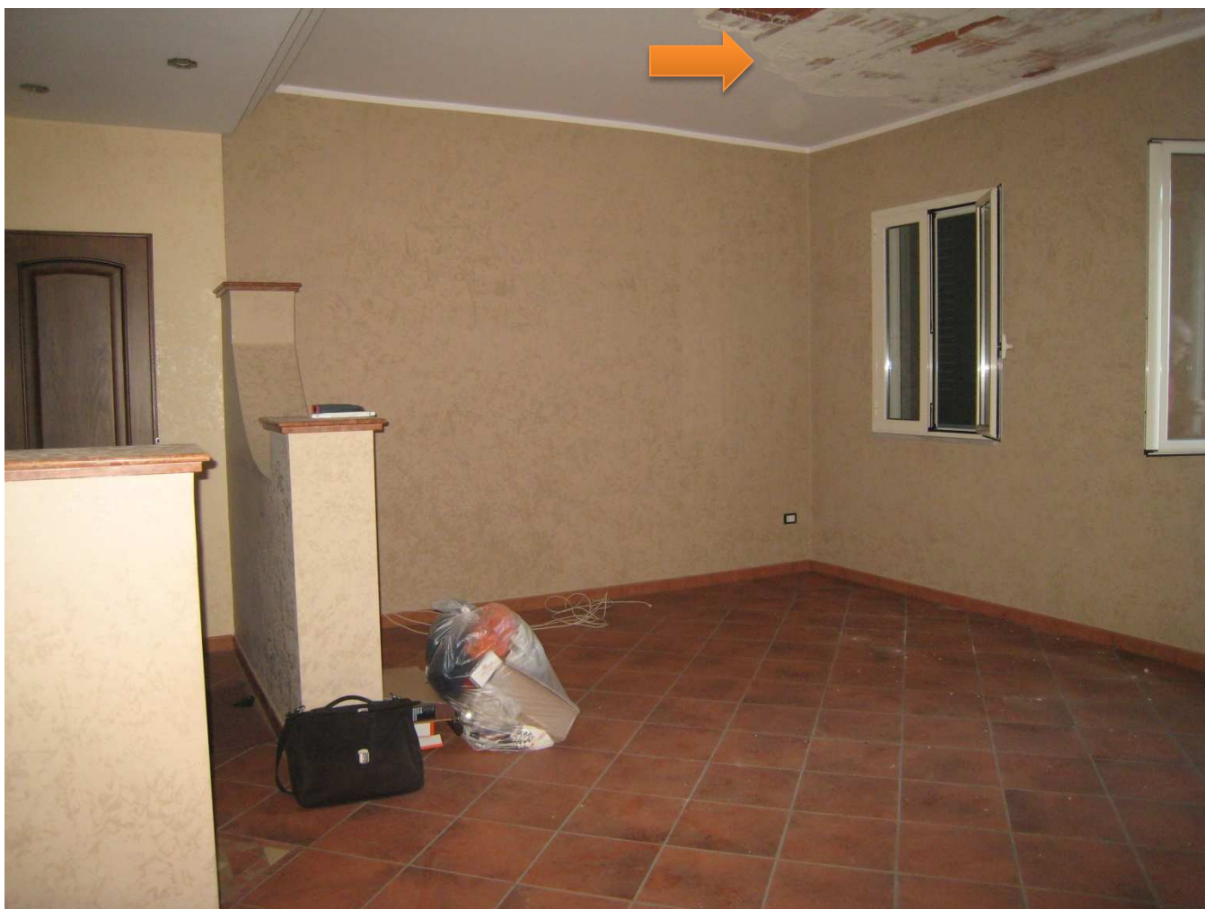
Foto n. 7. Altra vista del medesimo ambiente. Sul tetto i distacchi degli intonaci.
