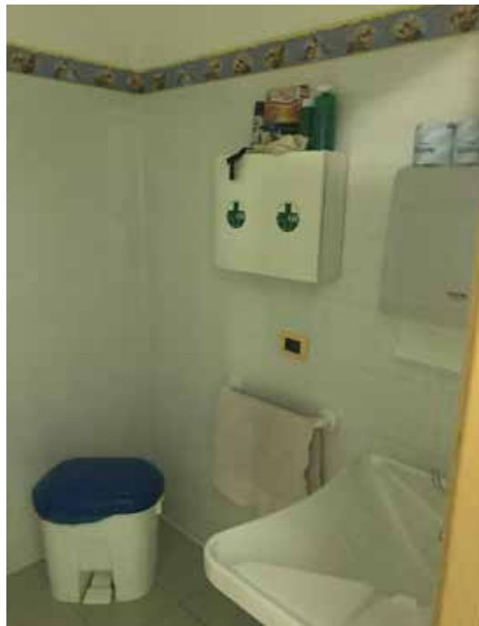
Foto 22. Servizio igienico disabili.
