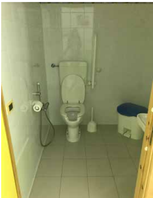
Foto 21. Servizio igienico disabili.
