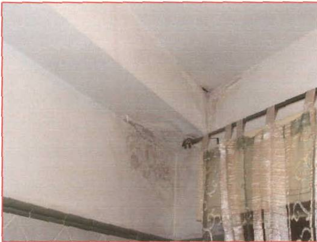
Foto 15: Particolare della presenza di umidità nel vano bagno
