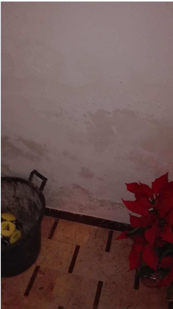
PARTICOLARE ANDRONE CON PRESENZA UMIDITA'
