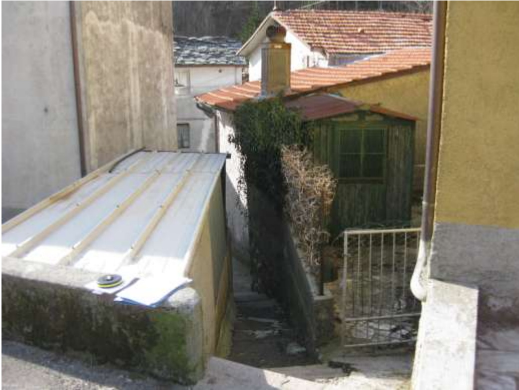
MANUFATTO PRECARIO SU RESEDE COMUNE LOTTO 1 E 2
