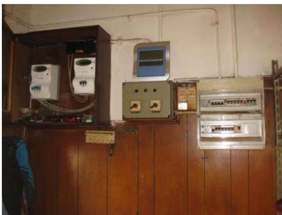
CONTATORI E QUADRI ELETTRICI DI CUI ALLA SERVITU' LOTTO 1
