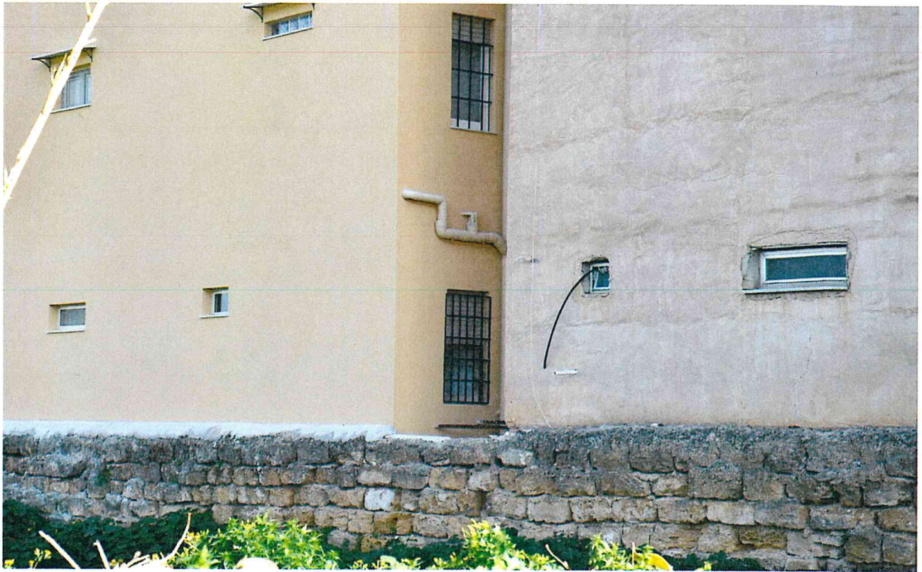
FOTO N. 5 PARTICOLARE PROSPETTO RETROSTANTE IN CORRISPONDENZA DELLE LUCI DI VEDUTA DEL PRIMO PIANO
