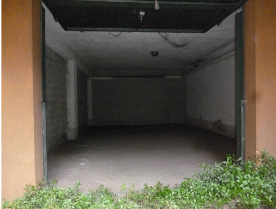
FOTO 7 – Box Sub. 6, interno
