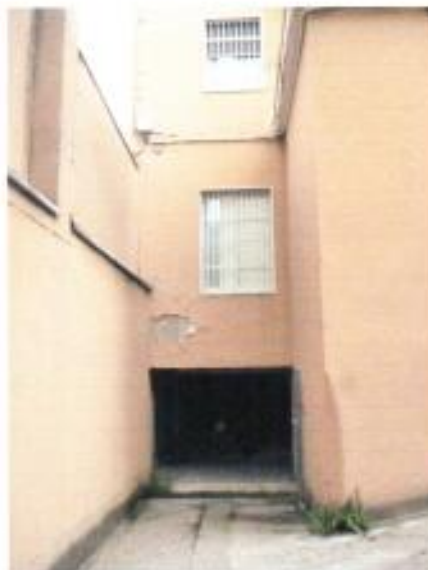
FOTO 5 – Retro dell'edificio, rampa e ingresso all'area comune di manovra antistante il BOX
