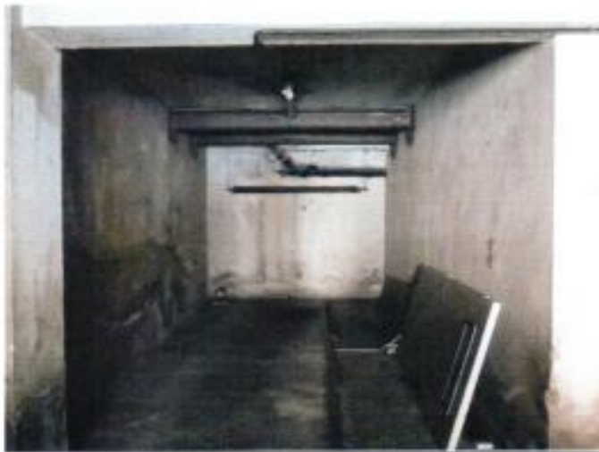
FOTO 7 – BOX Sub. 9, interna
