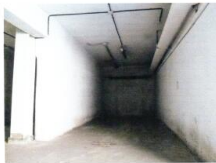
FOTO 11 - BOX Sub. 12, interno
