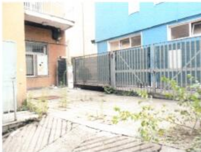
FOTO 4 – Stato di carente manutenzione dell'area antistante la rampa di accesso al BOX
