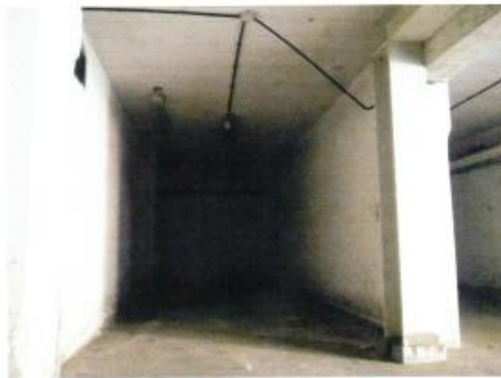
FOTO 10 - BOX Sub. 11, interno
