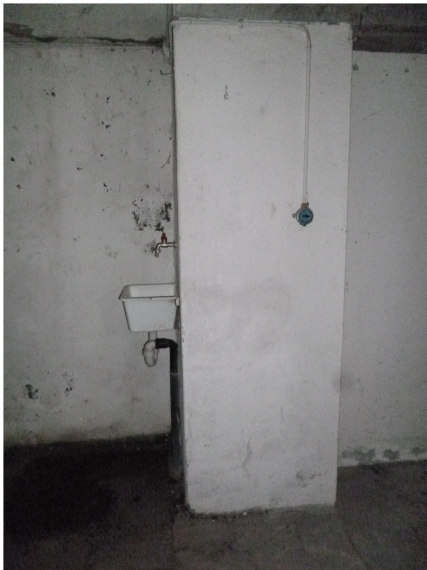
FOTO 6 – Particolare punto acqua BOX sub. 11
