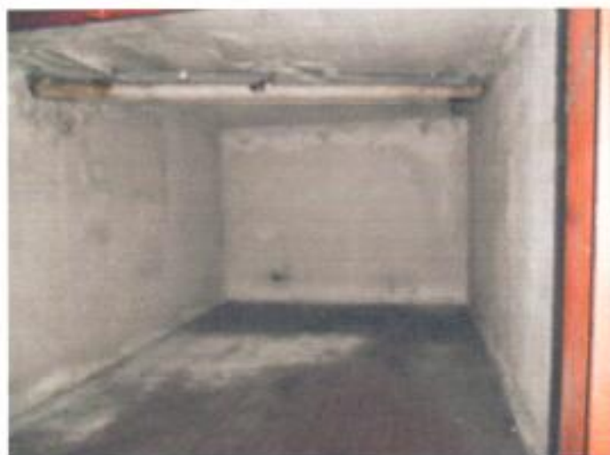
FOTO 12 – Box Sub 734 interno 10
