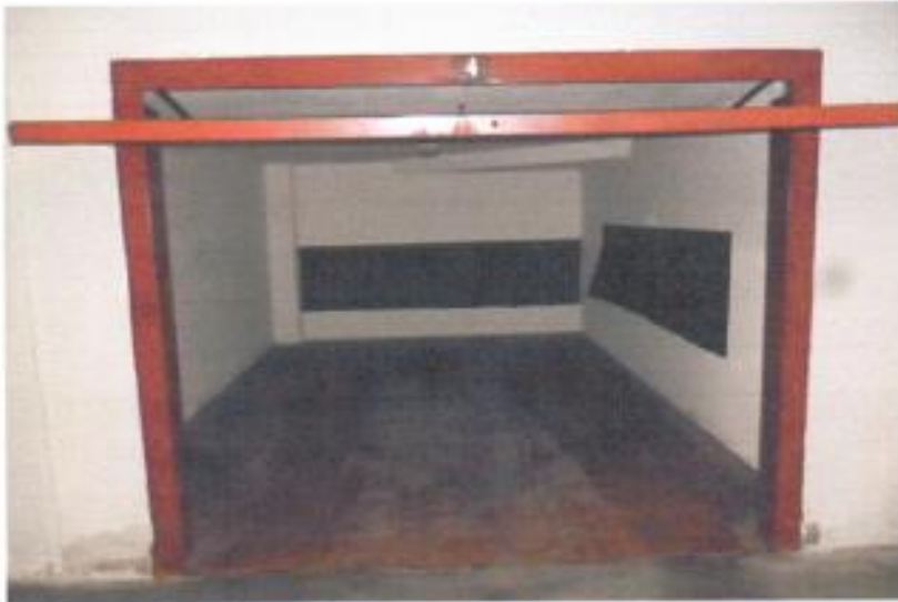
FOTO 8 - Box Sub 729 interno 4
