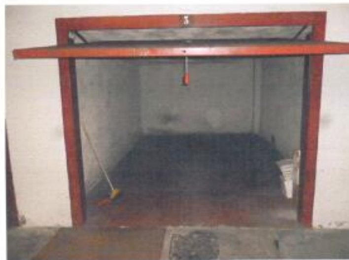
FOTO 7 - Box Sub 728 interno 3
