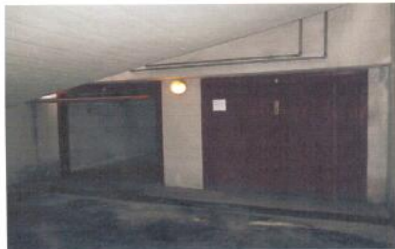
FOTO 10 - Box Sub 733 (a destra) e 734 (a sinistra) interni 9 e 10
