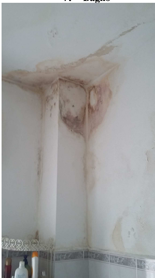
8. Bagno – danni cavedio
