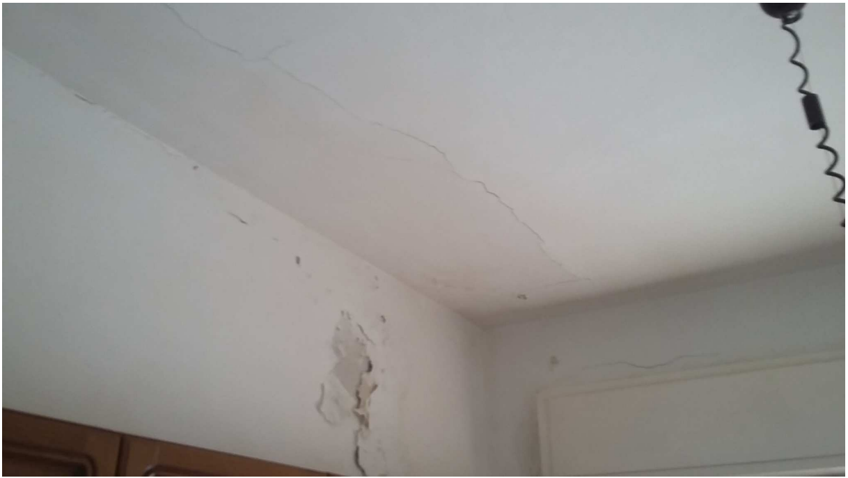
11. Cucina- danni intonaco solaio
