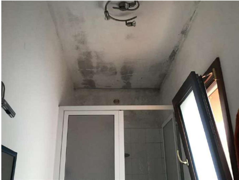
Foto n.13 Ammaloramenti nel w.c. doccia a primo piano
