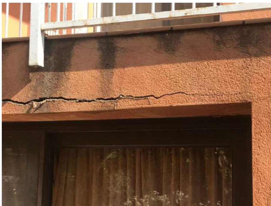
Foto n.21 Ammaloramento intonaci esterni
