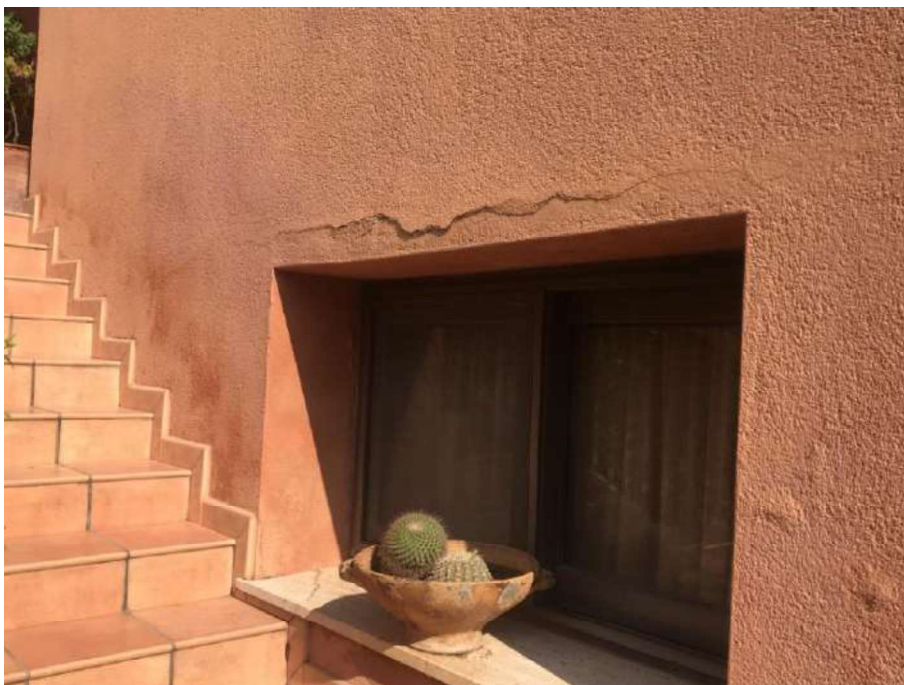
Foto n.20 Ammaloramento intonaci esterni
