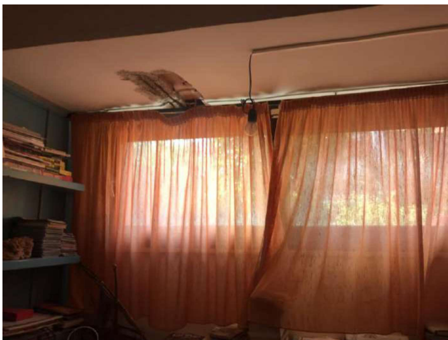
Foto n.17 Vano a piano seminterrato con solaio ammalorato
