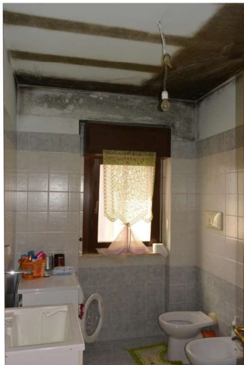
Doppio servizio -tracce di muffa sul tetto
