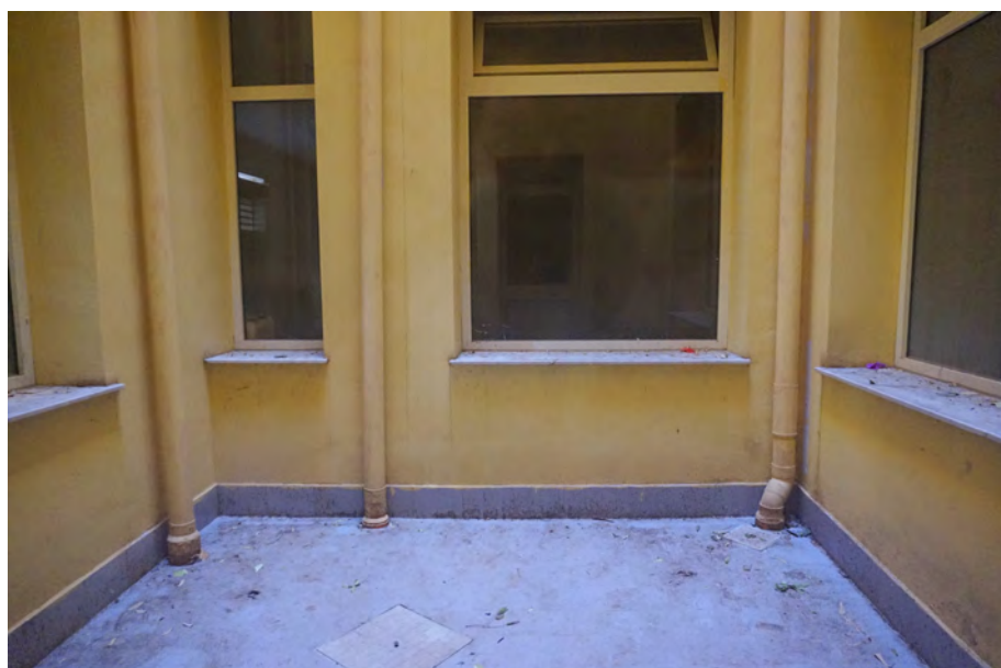
foto 29 - pozzo luce condominiale
