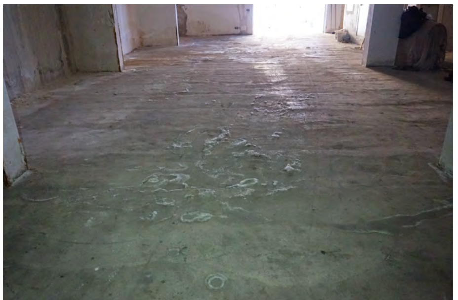
foto 36 - vista della pavimentazione dopo l'infiltrazione d'acqua
