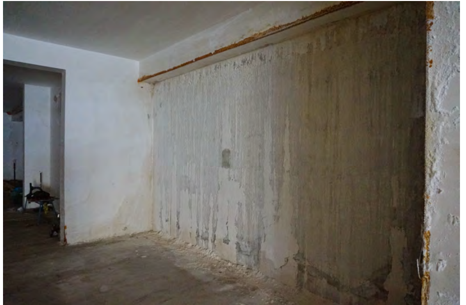
foto 34 - vista del muro ad est dopo l'infiltrazione d'acqua
