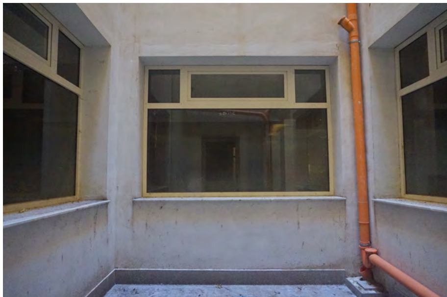
foto 28 - pozzo luce condominiale
