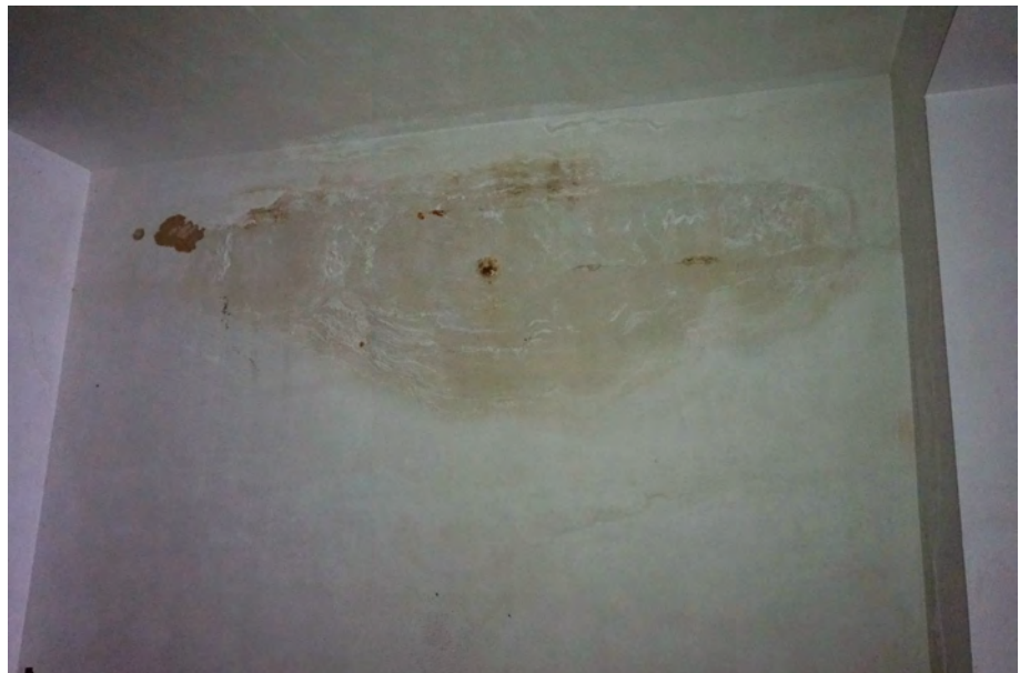
foto 35 - vista del muro ad Est dopo l'infiltrazione d'acqua
