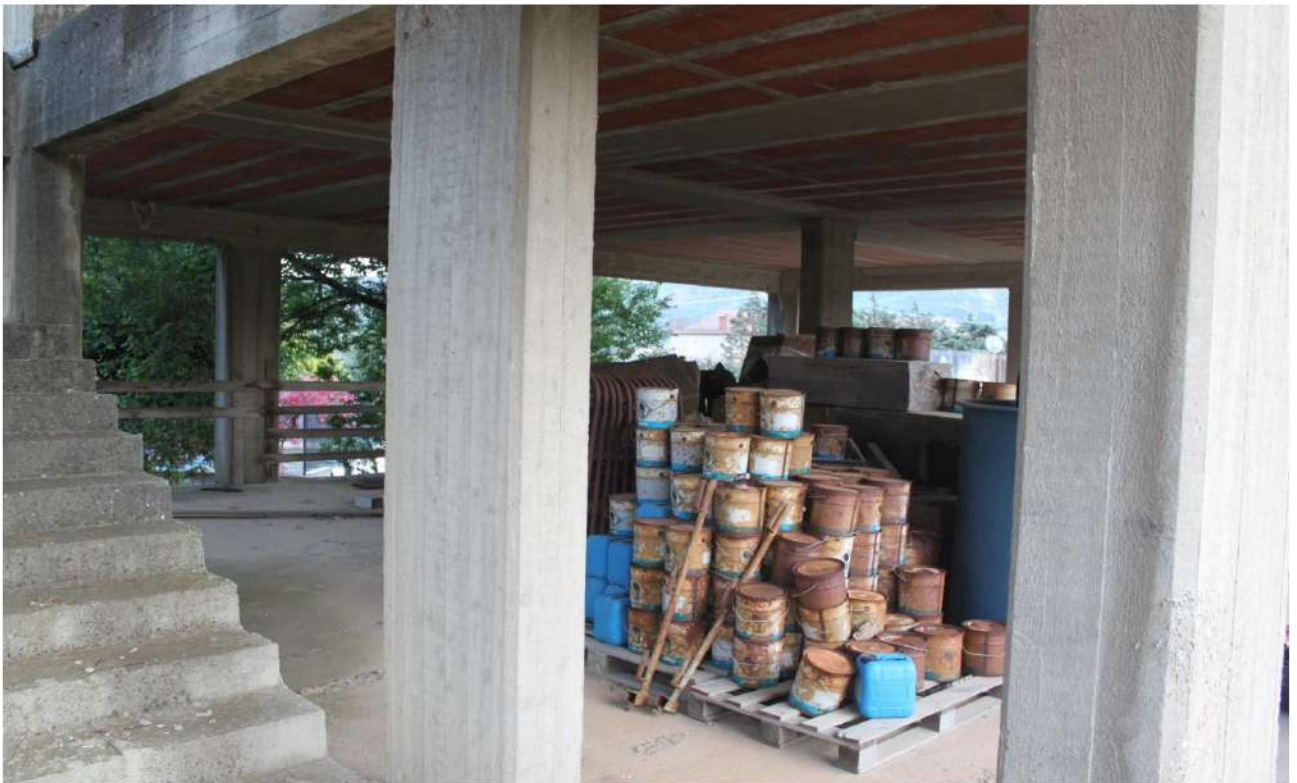
Manufatto a tre elevazioni fuori terra abusivo fig. 21 part. 1675
