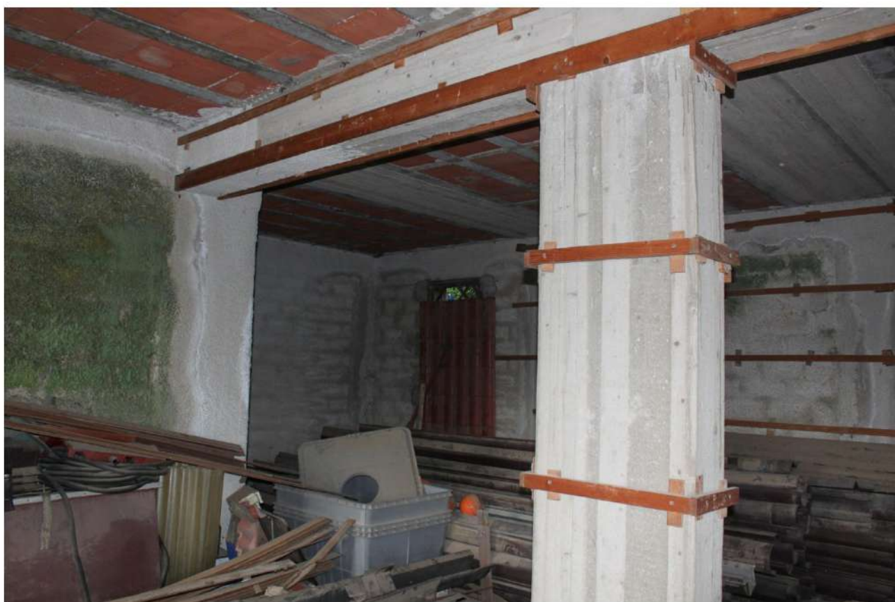
Manufatto a tre elevazioni fuori terra abusivo fg. 21 part. 1675
