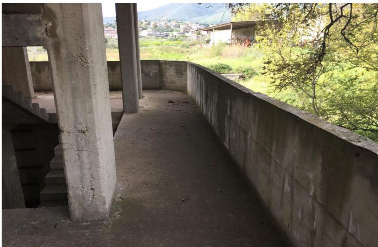
Manufatto a tre elevazioni fuori terra abusivo fg. 21 part. 1675
