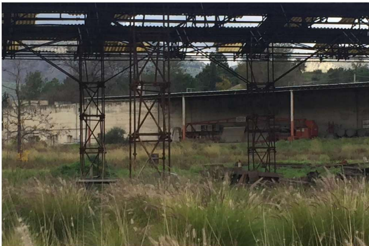
Manufatto abusivo in fondo mq. 420,00 - Ordinanza di demolizione n. 46/2001
