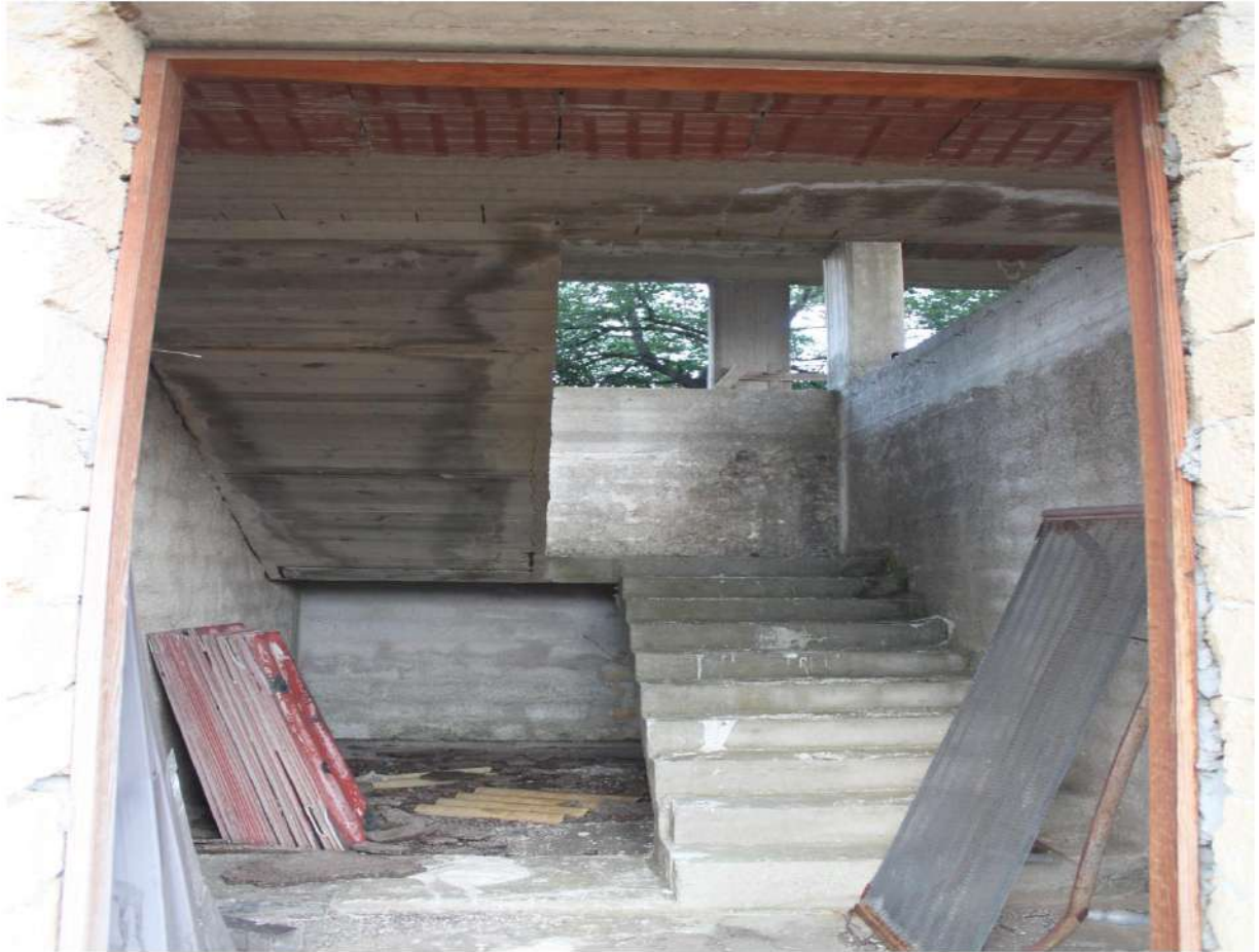
Manufatto a tre elevazioni fuori terra abusivo fig. 21 part. 1675
