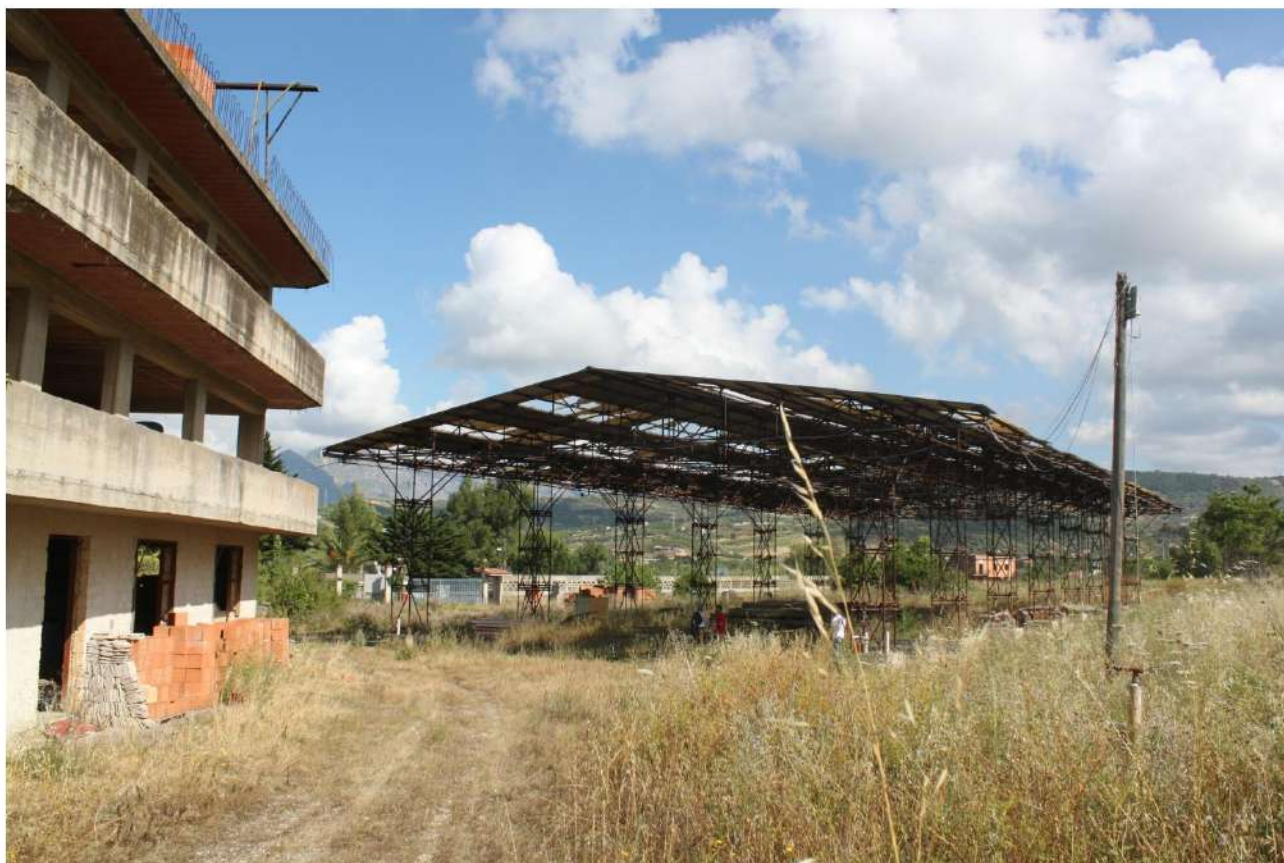
Manufatto abusivo oggetto di Ordinanza di demolizione n. 46/2001
